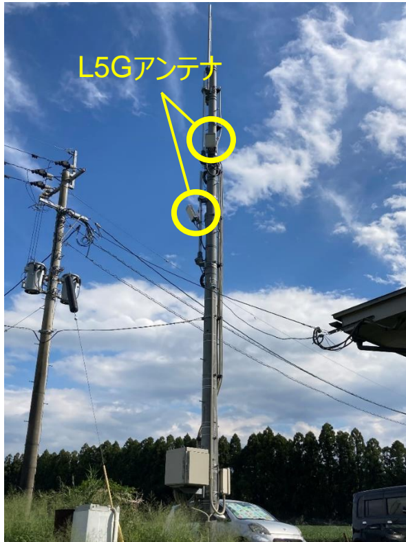
写真1 新設した電柱と L5G用アンテナ
