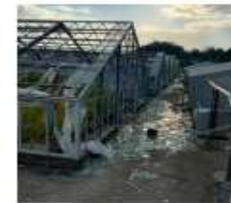
被災したガラスハウス (令和元年房総半島台風)
